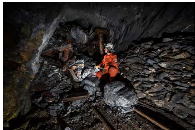
Abb. 129: Arthurstollen, Verbrüche in der Hauptstrecke haben 2017 zu vermehrten Anstrengungen bei der Streckensanierung, vor allem im Förderstollen, geführt; Foto: DBM/RUB, P. Thomas.
